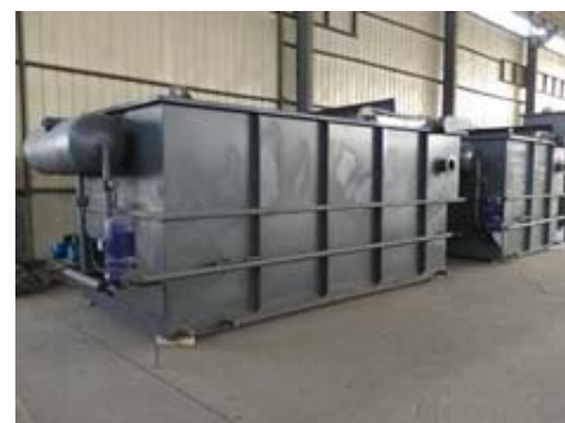
加圧浮上装置
